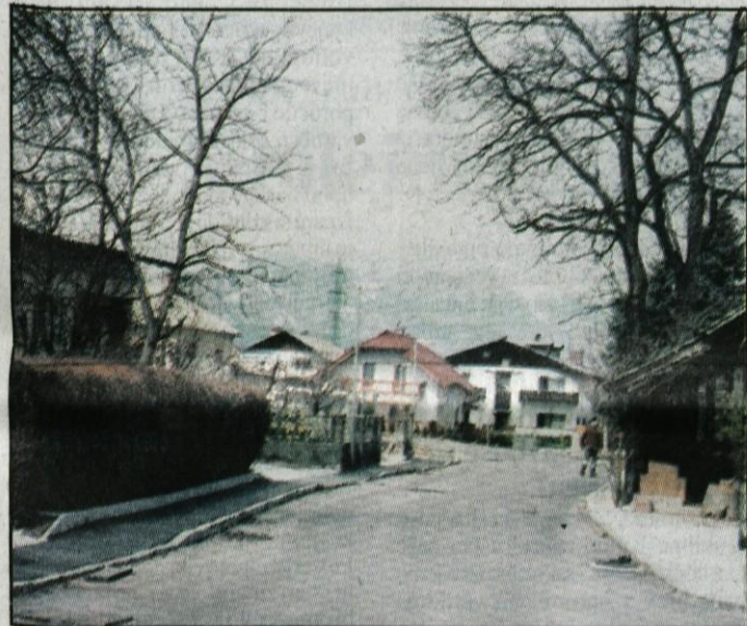
Gradnja Jarške ceste v dolžini skoraj kilometer je že zaključena. Vrednost del je bila kar 60 mio SIT.
