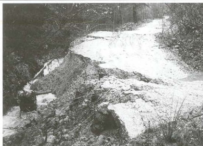
Poškodbe po neurju na gozdni cesti v Mežici.
