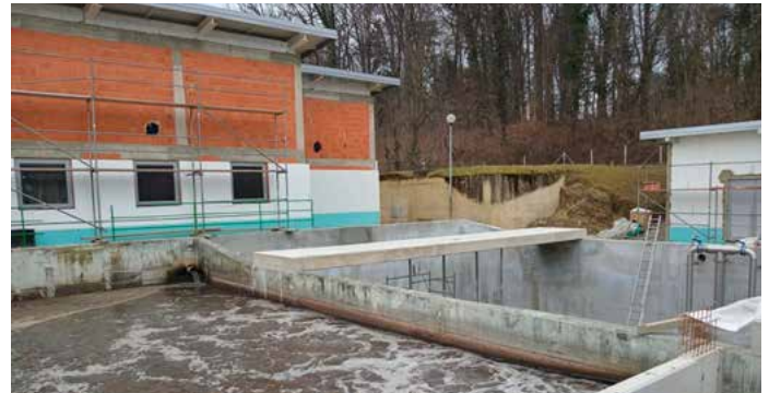
Pogled na rekonstruiran bazen, kjer se vpihuje zrak.
