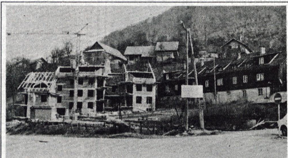
Na Mlaki v Tržiču Stanovanjska zadruga Gorenjske, z.o.o., Kranj z Zadržnim podjetjem Zveza, d.o.o., Kranj in pogodbenimi izvajalci, med katerimi je tudi Gradbeno podjetje Tržič, gradi tri bloke, v katerih bo deset najemnih stanovanj. Stanovanja bodo dobili občani občine Tržič na podlagi pravilnika, ki ga pripravlja država, Zadruga pa bo objavila razpis maja letos. Še letos pa bodo Mlaki začeli z gradnjo še štirih blokov za trg, v prihodnje pa bo na tem stanovanjskem kompleksu zgrajenih še šest blokov.
