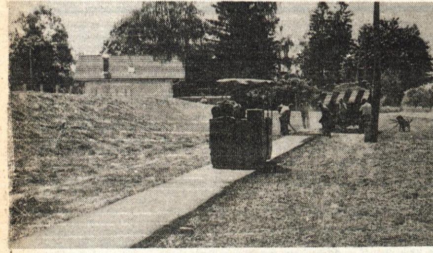
Bejunje — Delavci Cestnega podjetja Kranj so asfaltirali 500 m dolg ozek trak poti ob obeh cestah, ki obkrožata tovarno Elan. Cesta ob tovarni je namreč posebno obkrožena polna avtomobilov, mopedistov in kolesarjev, tako da je pešec tu zares ogrožen. Da bodo njihovi delavci, ki peš prihajajo na delo, varni pred tem prometom, so namesto pločnika zdaj naredili pešpot, ki so jo umaknili proti tovarniški ograji. — Foto: D. Dolenc.
