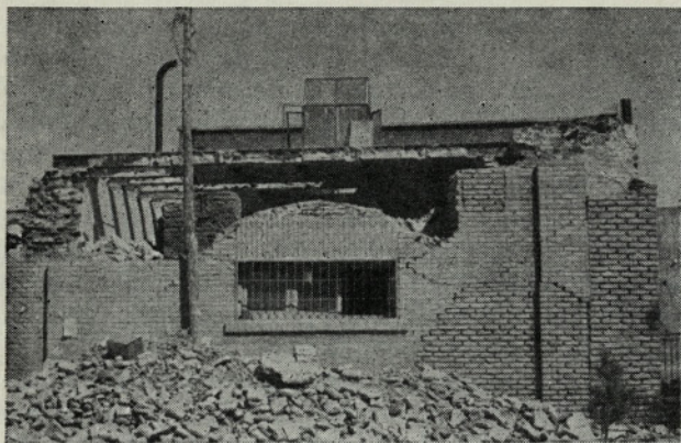
Sl. 20. Elektrarna v Ferdausu (Foto A. A. Moinfar)
