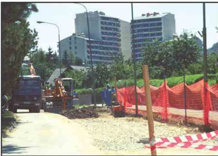
Stara kanalizacija na Gorici je povzročala veliko težav ob nalivih, saj je nemalokrat zalilo bližnje hiše. Obnovo naj bi odpravila tudi to.
