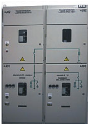
Srednjenapetostni stikalni blok 20kV
