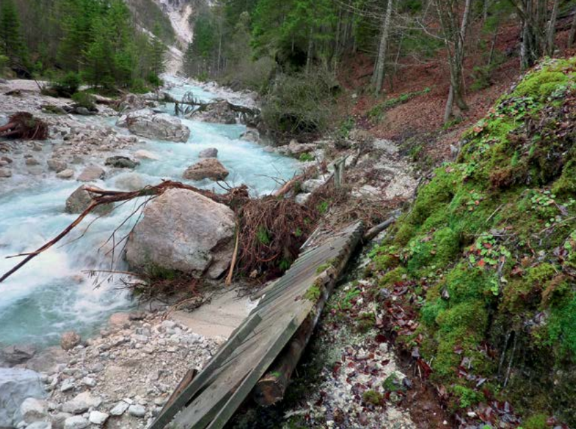
Poškodbe poti ob Triglavski Bistrici Foto Katja Gregorič
