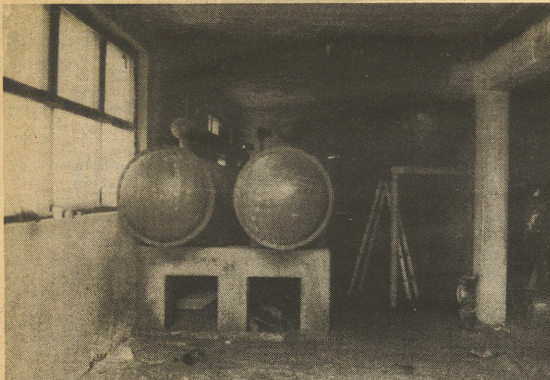
Vgrajeni tehnološki kotli
