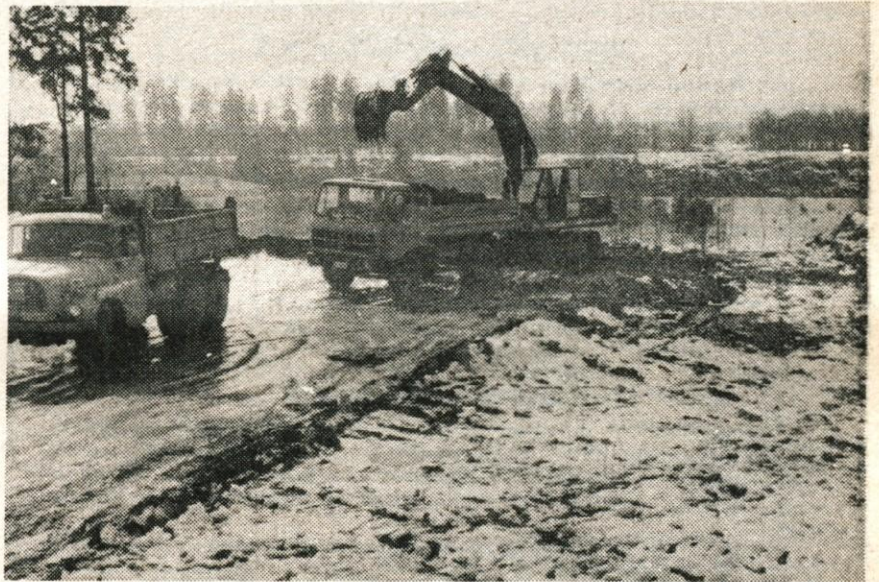
Gradbišče novega mostu čez Savo nad Planiko v Kranju. Most je prva faza uresničevanja desetletnega programa razvoja cestnega omrežja v kranjski občini. — Foto: F. Perdan
