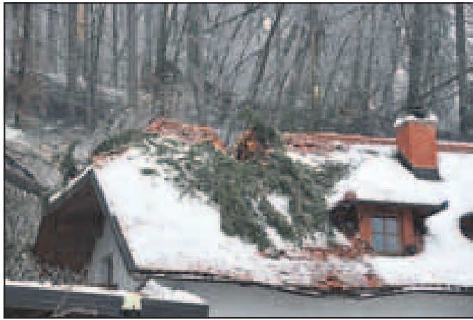
Drevo je poškodovalo stanovanjsko hišo [foto: Klemen Zibelnik].
