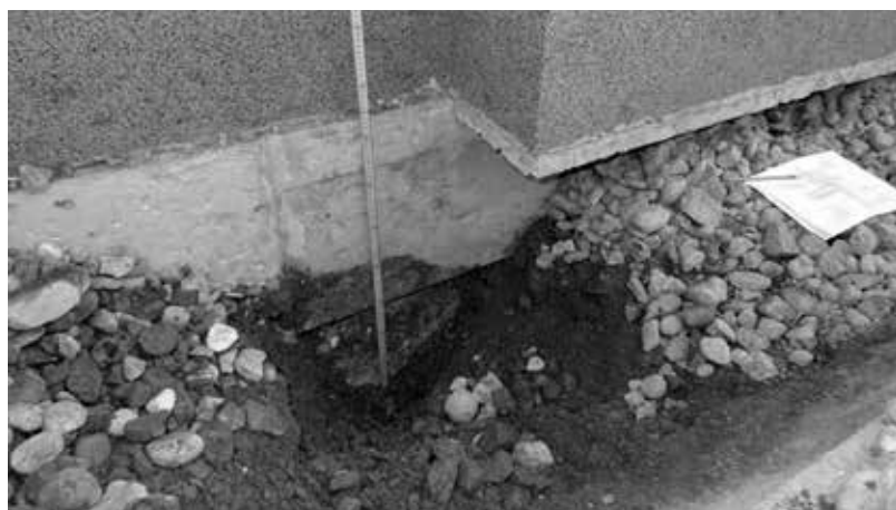
Energetski kiks št. 1: Toplotna izolacija dela stavbe v stiku z zemljo
