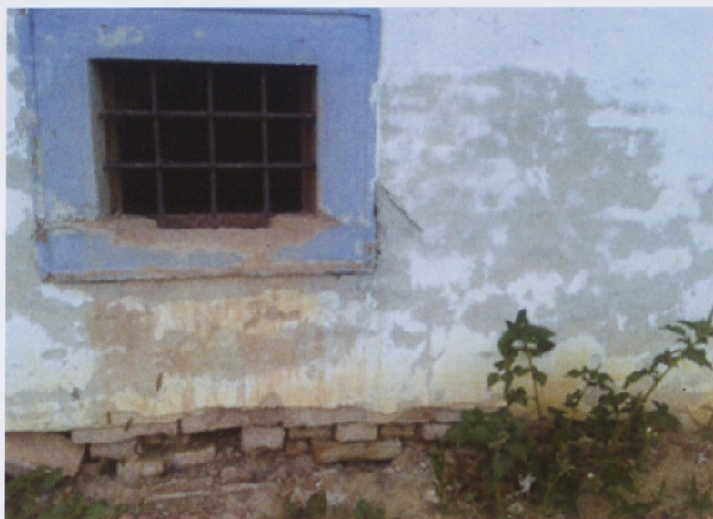
Primer obrob okoli oken in propadajoč fasadni omet.
