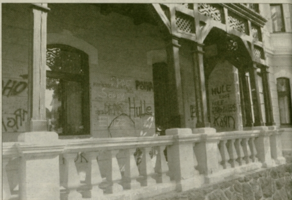
V Mayerjevi vili potekajo različne šolske in izvenšolske dejavnosti. Zunanji del vile pa propada tudi zaradi vandalov.
