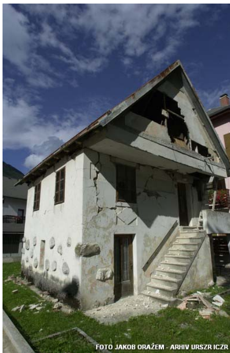
Slika 9: Potres v Bovcu julija 2004 je povzročil škodo na objektih (foto: J. Oražem).
