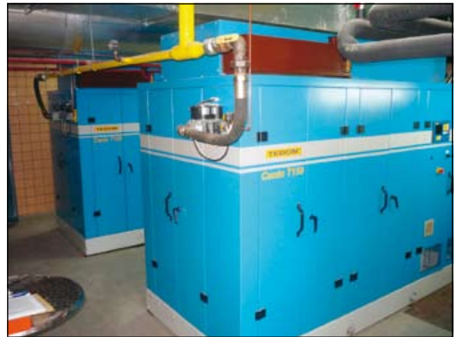
Enoti kogeneracijskega postrojenja v Park Hotelu Bohinj
