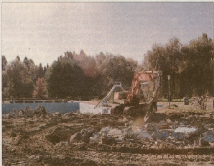
Pri odstranitvi dna so naleteli na slabše stanje, kot so pričakovali
