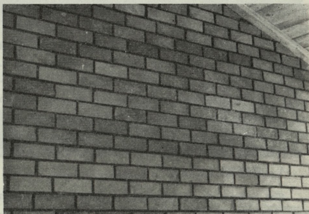
Sl. 2 Primer izcvetanja opeke, pozidane s cementno malto po očiščenju
