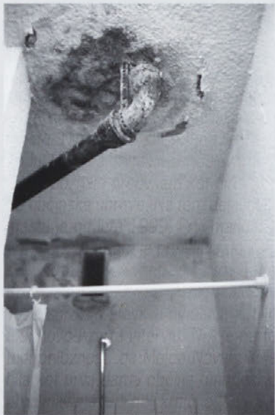
Eden od številnih kanalizacijskih odvodov nad tuši v študentskih kopalnicah. Včasih začnejo cevi puščati smrdečo rjavo brozgo.
