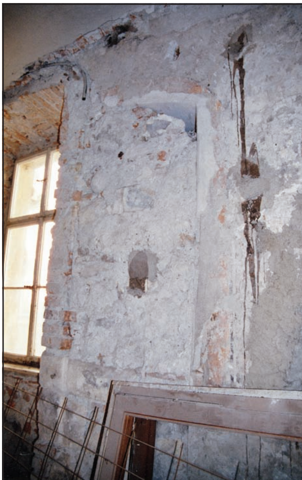
Slika 8: Notranji prostor ob glavni fasadi, odkritje dela segmentne odprtine s poslikavo (Foto: Maja Avguštin)
