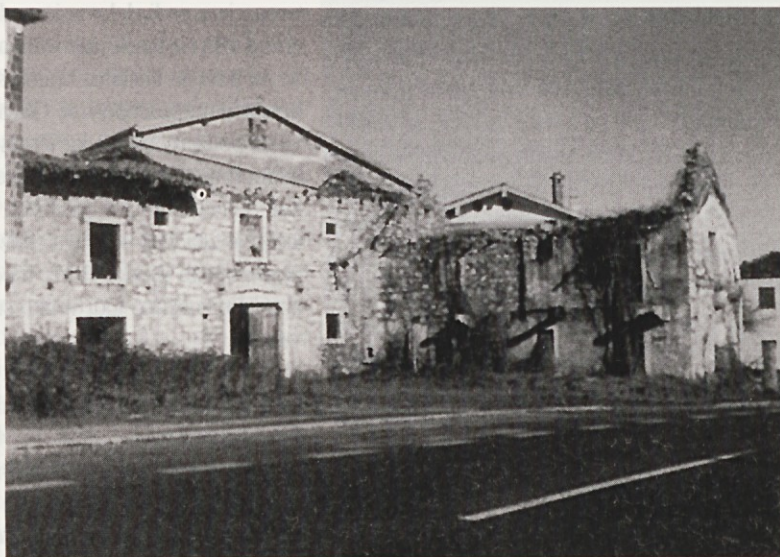
Propadanje "Radonove" domačije v Koprivi na Krasu v mnogočem "simbolizira" splošen odnos do dediščine stavbarstva. Iz knjige mag Ljuba Laha "Prenova stavbne dediščine na podeželju" (posnetki od leta 1985 do 1993)
