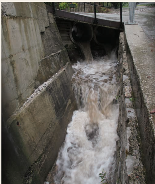
Evidentiranje že izvedenih (ustreznih in neustreznih) ukrepov za ravnanje s padavinskimi vodami [betonski zadrževalnik v obliki korita]. Foto: Kristina Klemen
