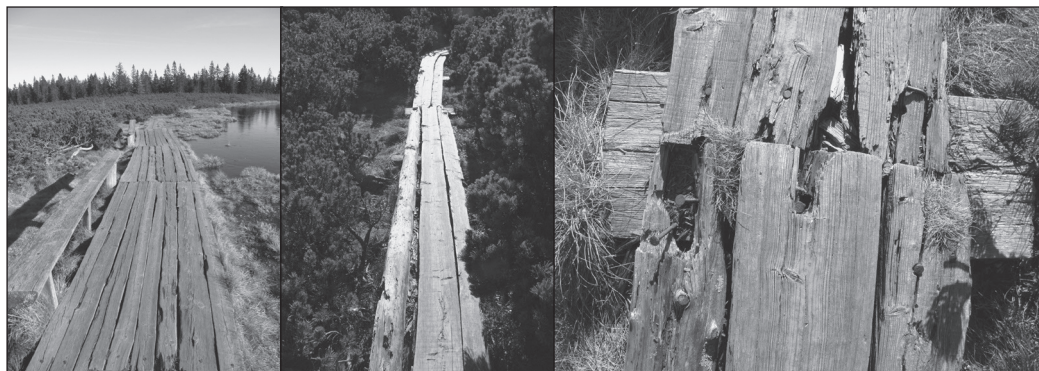
Slika 4: Dotrajana in nevzdrževana infrastruktura na območju Ribniškega jezera
