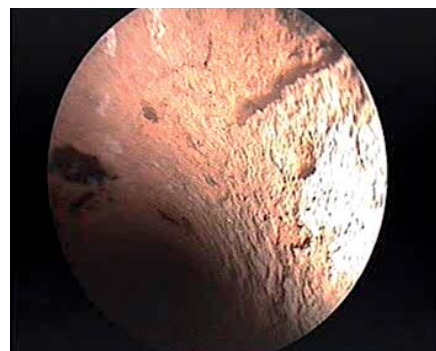
Slika 4: Endoskopski posnetek korodiranega mazalnega kanala.
