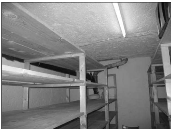
Nevarnost izliva fekalij v sodnem arhivu Okrajnega sodišča v Celju.
