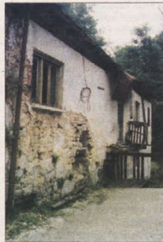
NEKOČ JE BIL... - ...mlin, bi lahko zapisali pod to fotografijo. Danes že pošteno kaže rebra, odrgani ostanki strehe grozeče visijo nad glavami obiskovalcev, kjer je bil nekdanj balkon, pa je le še nekaj kosov strohnjenega lesa.
