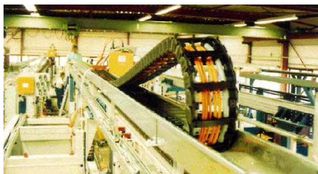
► Slika 1: Prikaz energijske verige z vgrajenimi visokofleksibilnimi kabli
