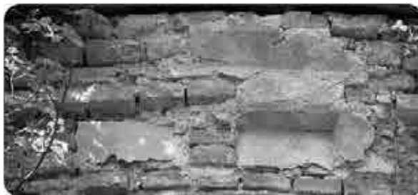
Na zunanjščini so fragmentarno ohranjeni ostanki členitve v ometu: konzolni podstrešni zidec, delilni zidec ter obrobe okoli oken in vrat.
