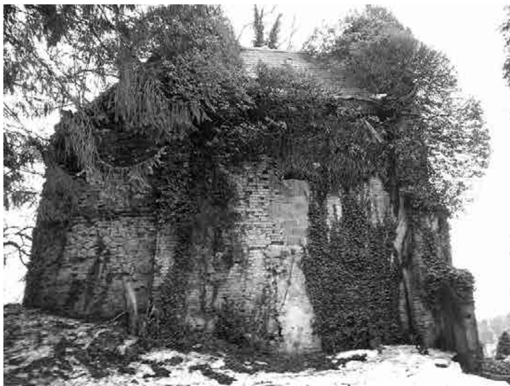
Severna stranica pozimi 2014: zazidana okna, povsem uničen omet, zaraščeno z bršljanom.
