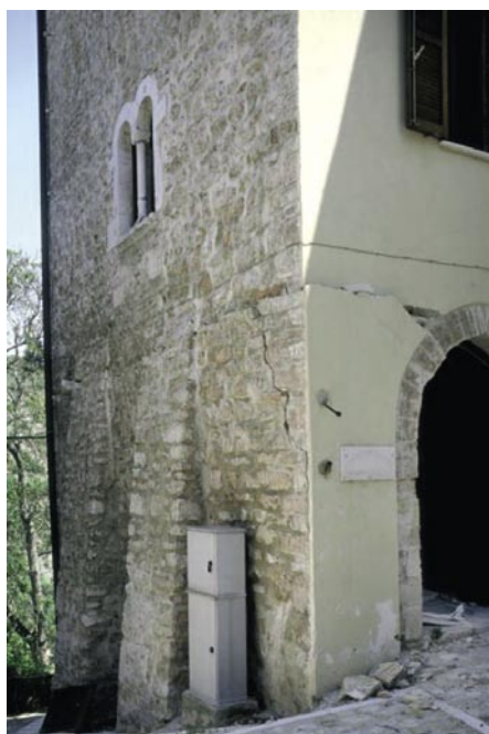
Slika 23 • Umbrija, 1997: toga armiranobetonska plošča je prestigla nosilno zidovje
