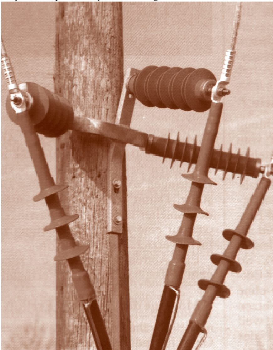
Slika 6: Prenapetostni odvodniki HDA prevzamejo dodatno funkcijo kot pomožna opora na daljnovodnem drogu.
