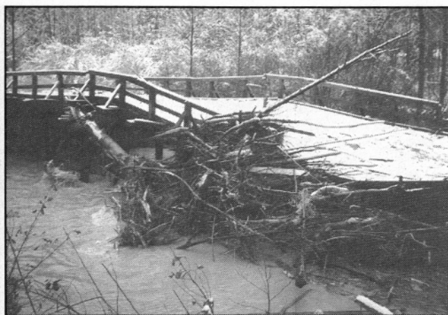
Porušen most čez Dreto na Kropi (foto: F. Kotnik)
