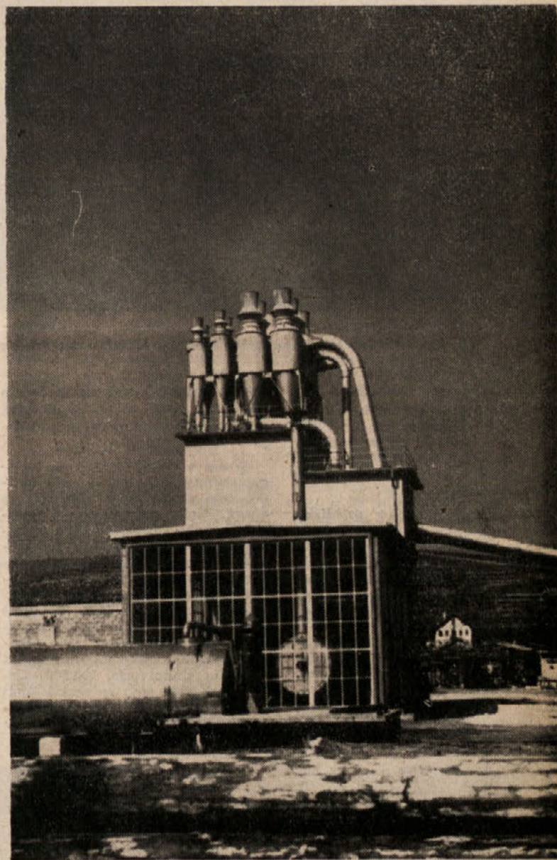
Izgradnja kotlarnice za LIP Slovenske Konjice je bila sorazmerno težavna, saj se prepleta vse polno cevi. Služi za ogrevanje sušilnice in ostalega tovarniškega prostora
