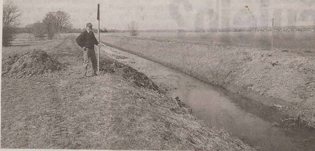
Most čez Lipnico je porušen, kup gramoza pa žal ne pomeni, da so se (že) začela dela za postavitev novega.
