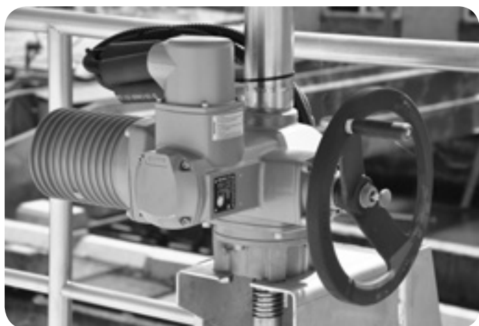
Velik del opreme je že vgrajen.
