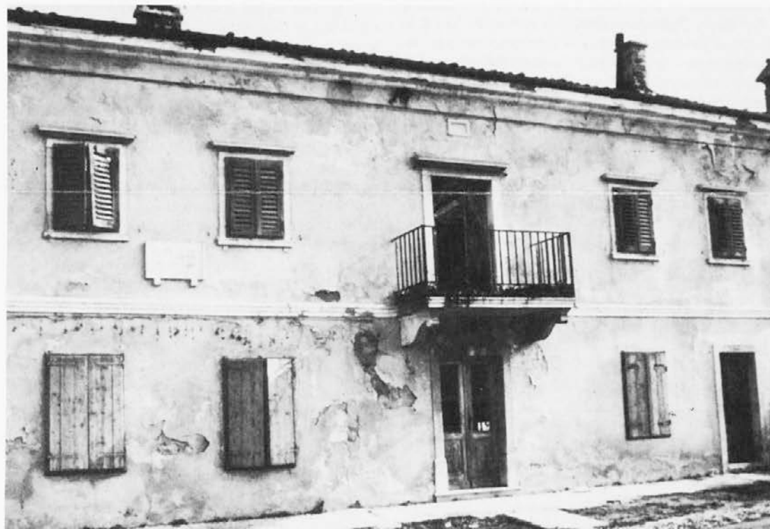
Kot je razvidno tudi na tem posnetku, potrebuje rojstna hiša Iga Grudna nujna popravila
