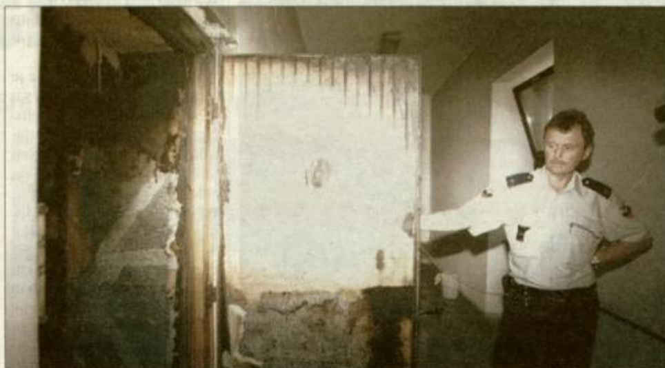
Soba 222 v celjskih zaporih po požaru.
