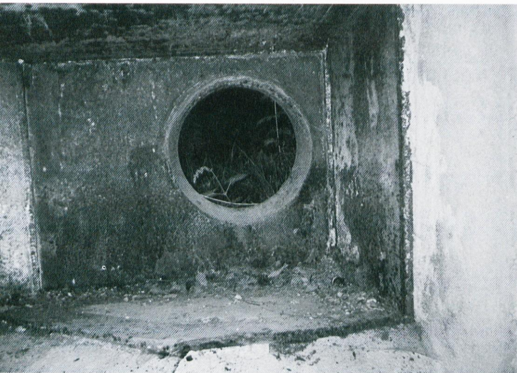
Stranska strelna lina v tipičnem strojničnem bunkerju
