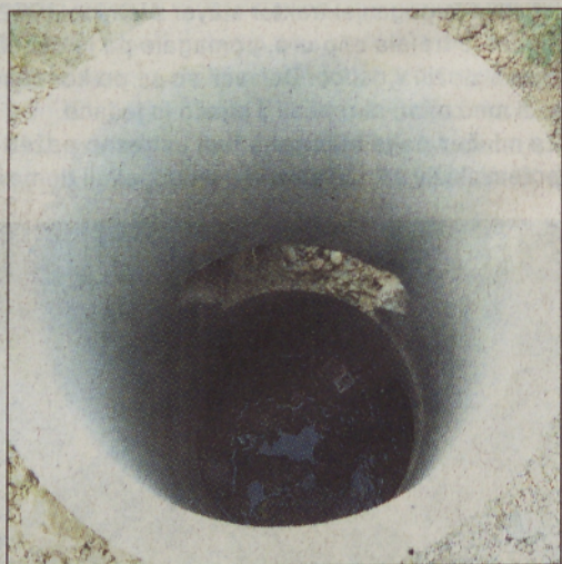
Na mestu izvira kakovostne pitne vode je sedaj nastala zabetonirana umazana kanalizacija. Foto: TK
