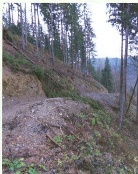
Posledice vetra in slabega odvodnjavanja na vlaki v gozdu
