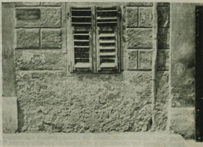
Do skrajnosti zanemarjeno pritličje hiše št. 18 v Kidričevi ulici
