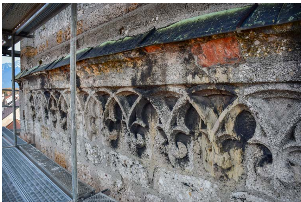
6. Tretji venčni zidec na zvoniku v Kranju s slepimi trilisti pred posegi (© ZVKDS, foto: Matevž Remškar)
