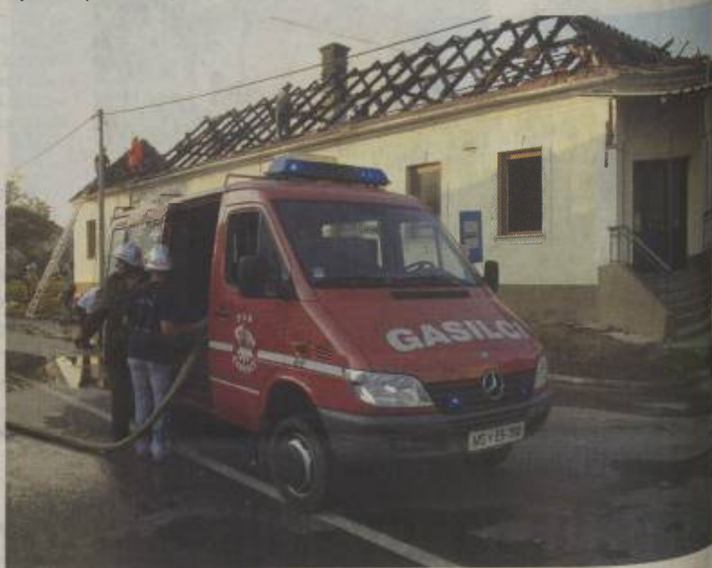
V Šalovcih je zagorelo zaradi varjenja pri popravilu centralnega ogrevanja.
