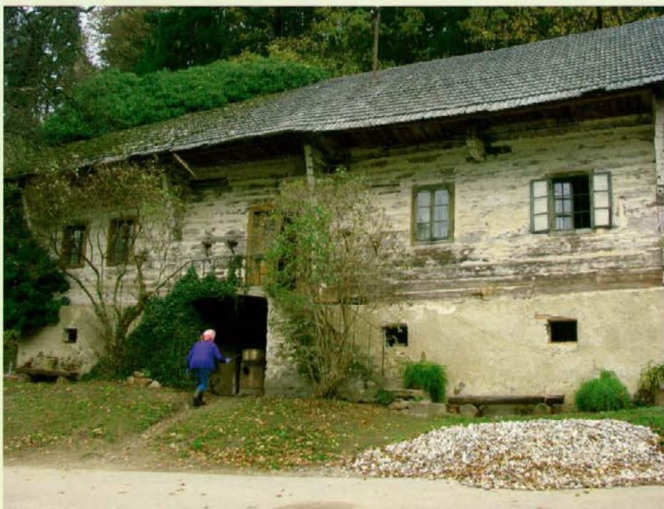
Stara stanovanjska hiša je potrebna obnove.
