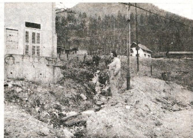
Naplavina hudournika tik nad glavno cesto Kamnik-Črnivec.
