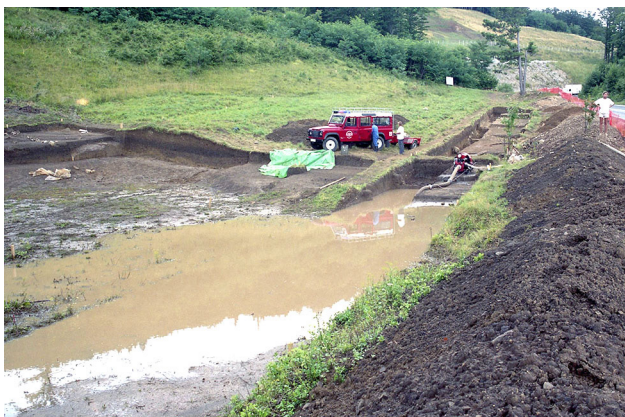
22 Podnanoški gasilci pri črpanju deževnice iz poplavljenega osrednjega dela izkopišča.
