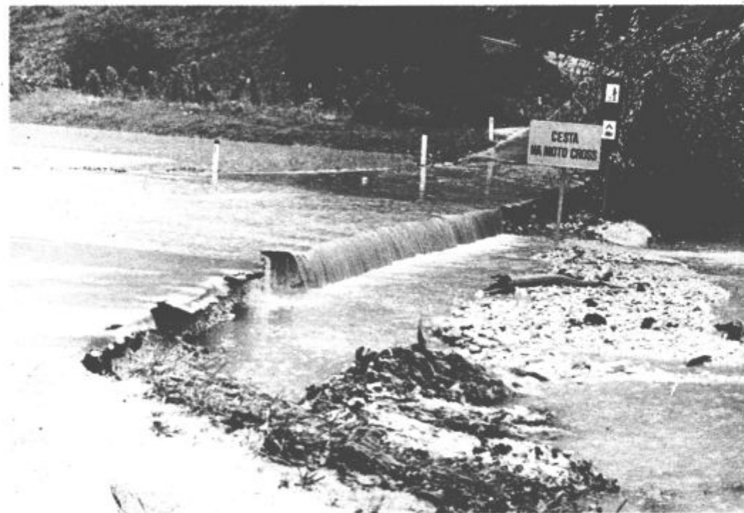
Takole je voda poškodovala cesto v Paki
