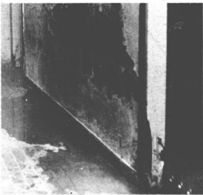
V kletnih prostorih je voda močno poškodovala stene
