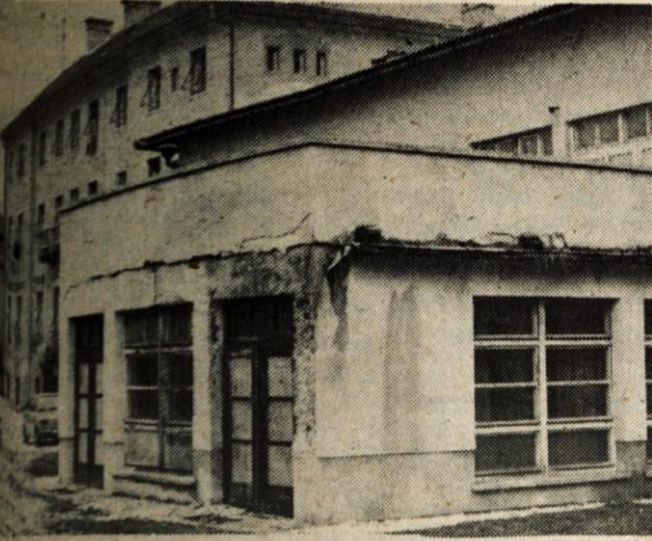
Delavskega doma je prepotrebno obnove, že leta nihče ni vzdrževal, saj tudi amortizacije niso plačevali.
