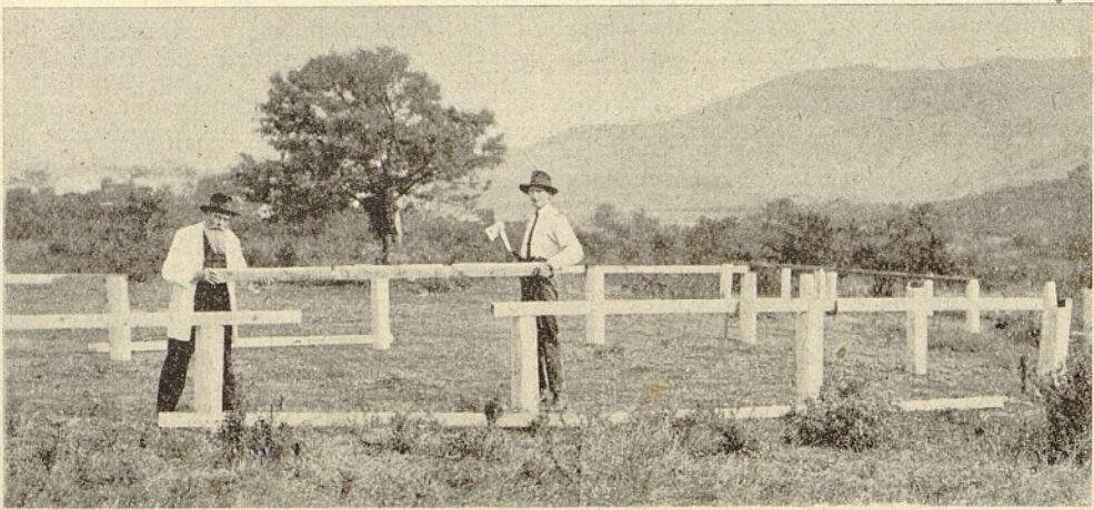
P. Jörn beginnt mit Br. Vogel den Bau einer Schule in Noordkap.
